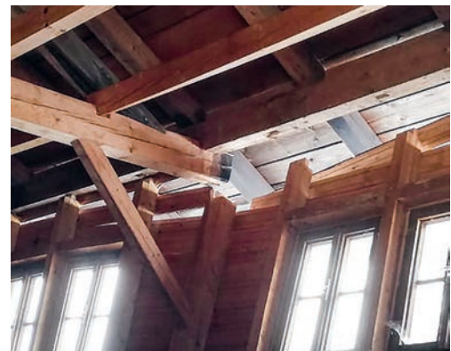
Bild 3: Ein kleiner Eindruck vom Ausmaß der Schäden.
