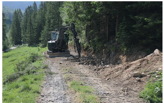
Bild 5: Auf der Zufahrtstraße vom Grünsee zur Hausalm mussten die Pioniere für die Entwässerungsgräben an manchen Stellen Schremmarbeiten durchführen. Mit dem JCB – einem Allroundgerät der Pioniere – entfernte man das nicht benötigte Abbruchmaterial. Auch hier wurde die Straße vorerst geebnet und anschließend das Endmaterial aufgebracht und verdichtet.
