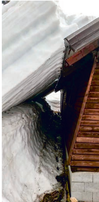
Bild 1: Der Druck der abgeglittenen Schneeschicht hat die Baracke stark verformt.
