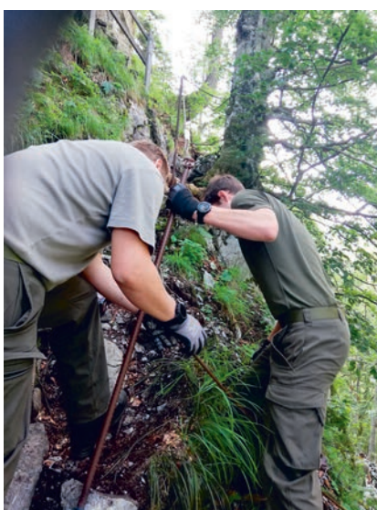
Bild 5: Einige Sicherungen wurden auf der MG-Nase mit Eisenstangen und Drahtseilen gebaut. Auch hier gab es enorme Schäden. Die verbogenen Eisenstangen mussten aus dem Erdreich gezogen und mithilfe eines Gasbrenners gerade gebogen werden.
