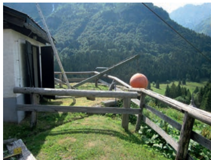
Bild 3: An der Nordseite der Seilbahnstation: der kaputte Mast für die Warnkugeln und der beschädigte Zaun.
