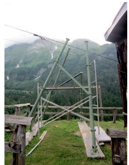
Bild 4: Die Reste der beiden A-Stützen vor dem Gebäude. Die Seilklemme zur Sicherung des Tragschuhes ist gut zu erkennen.
