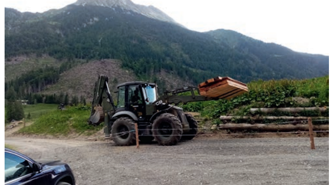
Bild 6: Während der Arbeiten an der Zufahrt zur Hausalm traf die Lieferung des bestellten Bauholzes für den Kleinen Pal ein. Wir waren sehr dankbar, dass die Pioniere das Holz mit ihrem JCB vom Parkplatz beim Plöckenhaus über die Baustelle zu uns auf die Hausalm schafften.
