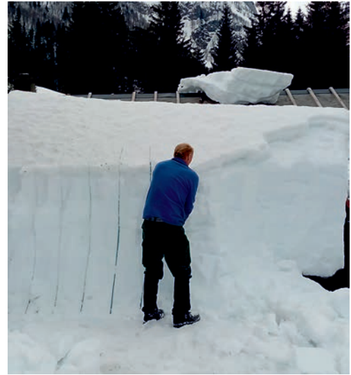
Bild 2: Die sehr kompakte Schneeschicht musste mit der Motorsäge zerlegt werden.
