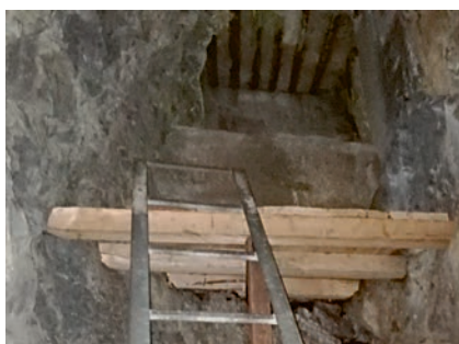
Bild 7: In der Beobachtungsstelle (Objekt Nummer 4) befand sich ein durch die Feuchtigkeit in die Jahre gekommenes Podest am Ende der Eisenleiter. Dieses wurde von den Soldaten ebenfalls erneuert.
