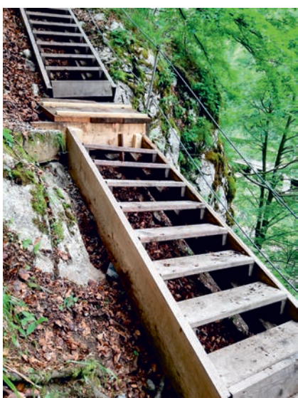
Bild 4: Nach dem Hochheben und neuen Unterpöhlen der eingesunkenen Treppenseite wurden die kaputten Teile ausgetauscht und das Podium verstärkt.
